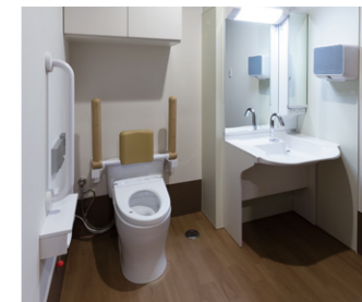
安全に配慮した水回り
